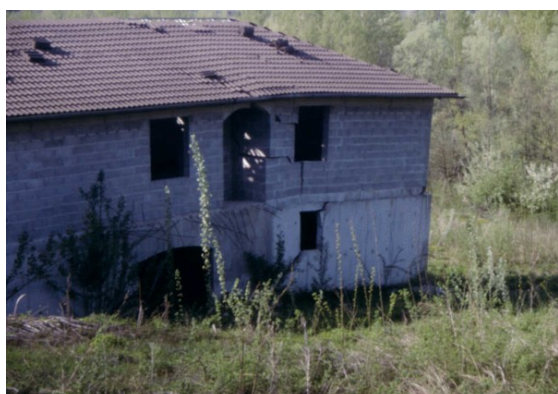
Figure 8: Élevée (gi3) : Destruction du bâti standard. Dommages structurels au bâti adapté à l'aléa moyen
