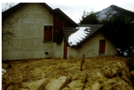
Figure 10: Modérée (gi2) : Dommages structurels au bâti standard. Pas de dommages au bâti adapté à l'aléa
